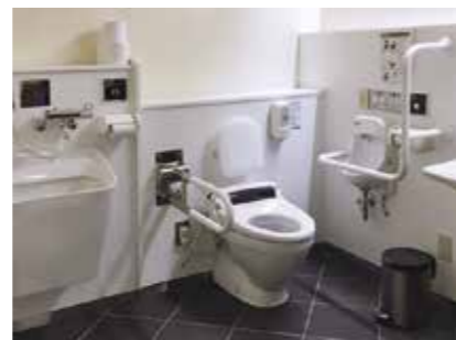
●2階多目的トイレ(オストメイト対応有)
