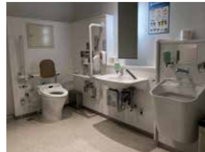
●1階多目的トイレ(オストメイト対応有)
